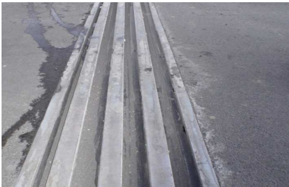
Rys. 15. Północne urządzenie dylatacyjne na podporze nr 13. Zapracowało prawidłowo w trakcie pożaru, ale uległo uszkodzeniu – nie pracuje jeden moduł urządzenia
