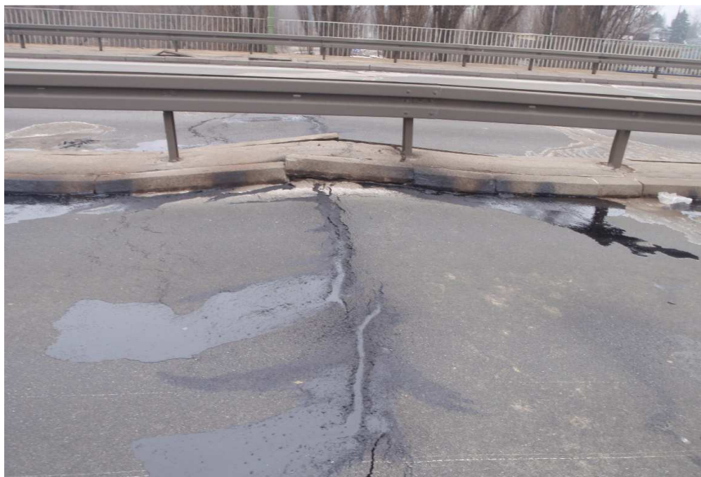
Rys. 8. Przęsło nr 12–13. Bardzo duża deformacja nawierzchni. Przemieszczone krawężniki i bariery ochronne
