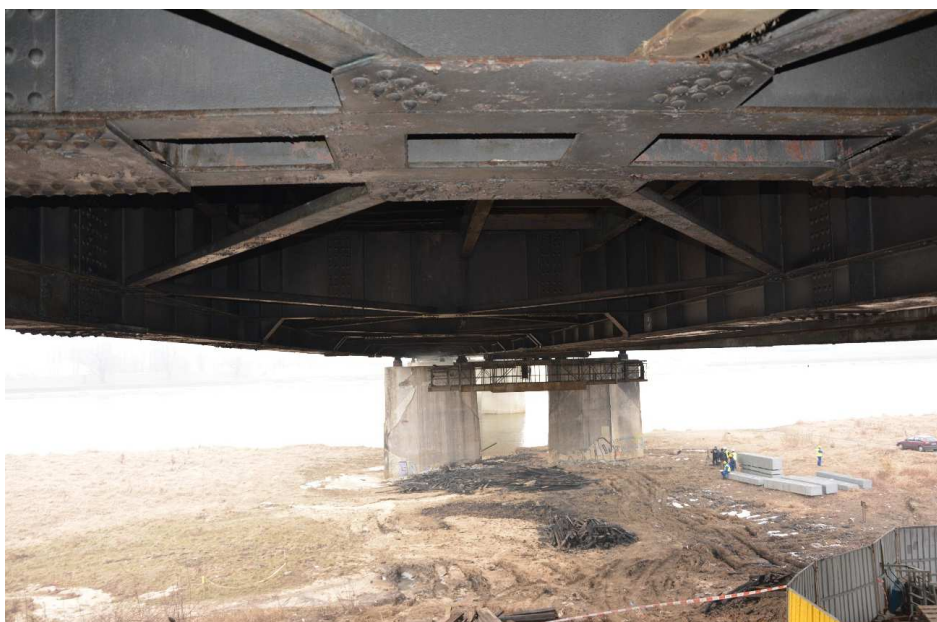
Rys. 13. Przęsło nr 12–13 widoczne z podpory nr 13. Widoczne trwałe ugięcia dwóch dźwigarów północnych (prawa strona zdjęcia) zdecydowanie większe od trwałego ugięcia dwóch dźwigarów południowych (lewa strona)
