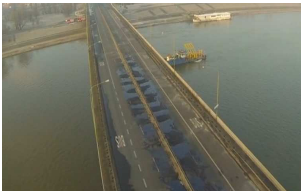
Rys. 7. Przęsła nr 10–13. Stopiona nawierzchnia i izolacja bitumiczna, przemieszczone krawężniki, duże deformacje nawierzchni jezdni południowej [źródło: www.gazeta.pl ]
