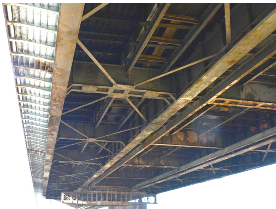
Rys. 14. Przęsło nr 12–13. Widoczne pochylenie skrajnego dźwigara południowego w kierunku osi podłużnej mostu
