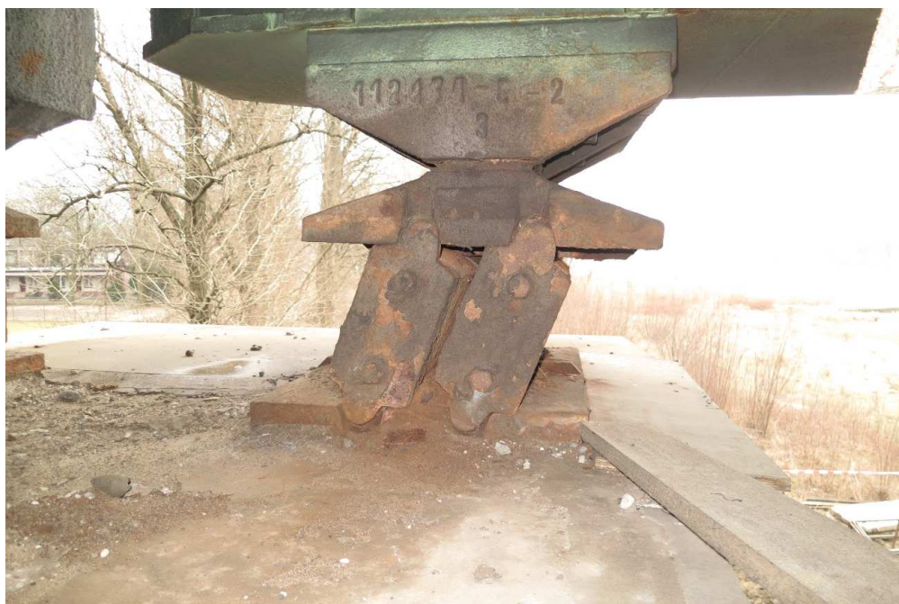
Rys. 12. Łożysko na podporze nr 13 (2015-02-19) w maksymalnie wychylonej pozycji przy temperaturze zaledwie 4°C
