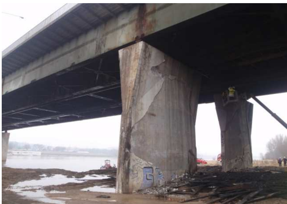
Rys. 6. Podpora nr 12. Odspojona otulina oraz rdzawe zacieki na południowej powierzchni podpory
